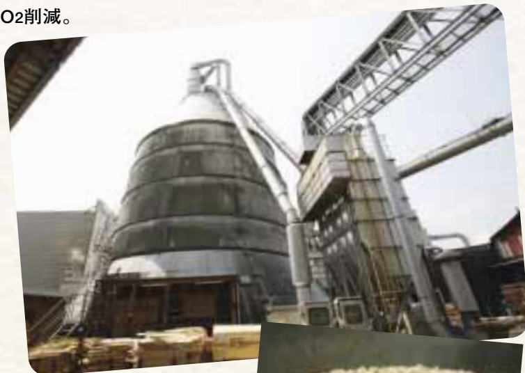
木くずを燃料に発電を行うボイラー。 製造工程で出る木くずを使うので、 廃棄物の削減にもなる。
